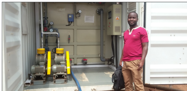
James nous montre les systèmes d'assainissement et de gestion de l'eau de la base de l'ONU à Daloa (programme VNU, 2016)
